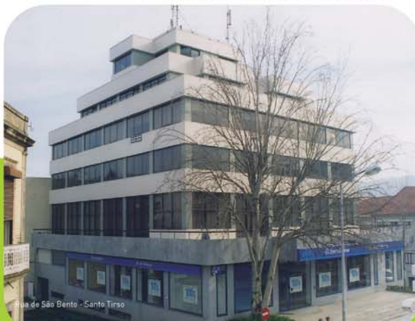
Reabilitação integral do edifício: cobertura, terraços e fachadas (tratamento localizado e aplicação de hidro-repelente na fachada).
